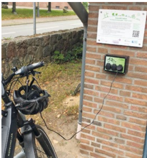
Die E-Bike-Ladestation in Aktion. Die Infotafel informiert über das Projekt „Zukunft leben“.
